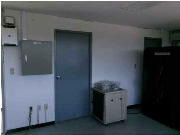
손상내용 전력 배전반 및 전기설비 상태양호 손상원인 -
