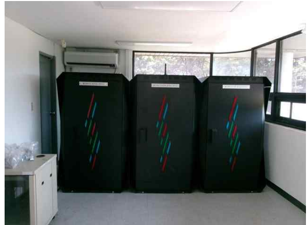
전기실 내부 전경
