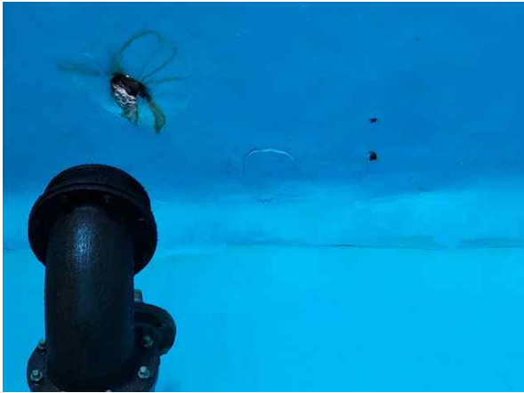
손상내용 2지 상부슬래브 박락 손상원인 다짐미흡
