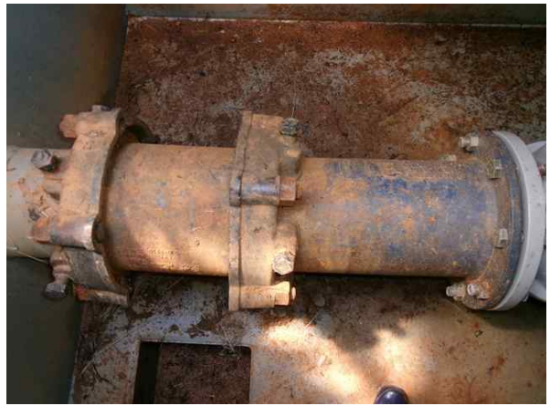
손상내용 드레인실 밸브, 배관, 볼트류 부식 손상원인 온도차에 따른 습기흡착 등
