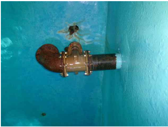
손상내용 1지 유입 배관 차수불량 손상원인 공용기간 증가
