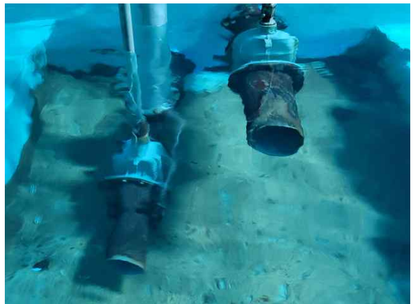
손상내용 2지 배관 부식 손상원인 공용기간 증가 등
