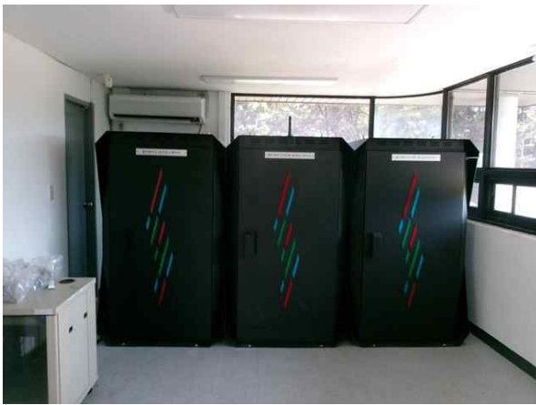
손상내용 전기실 전기설비 상태양호 손상원인 -
