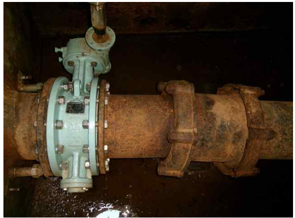
손상내용 유입밸브실 밸브, 배관, 볼트류 부식 손상원인 온도차에 따른 습기흡착 등
