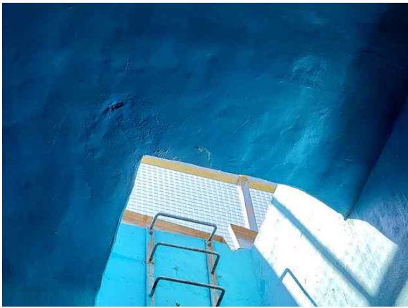
손상내용 2지 상부슬래브 백태 손상원인 온도차로 인한 습기흡착
