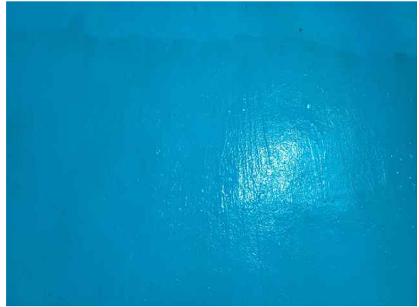
손상내용 2지 벽체 도장기포 손상원인 도장미흡
