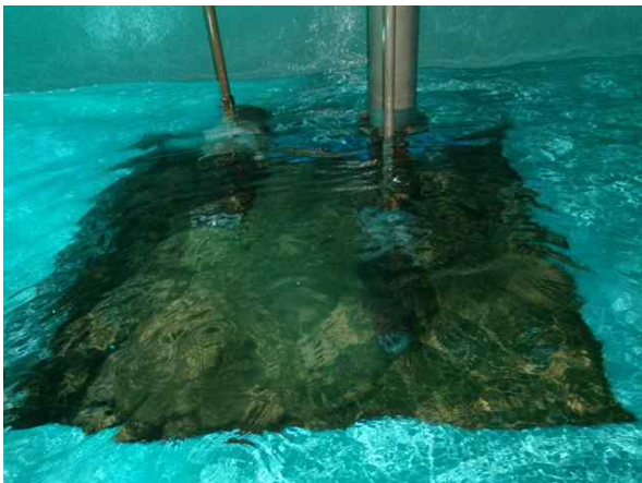
손상내용 1지 배관 부식 손상원인 온도차에 따른 습기흡착 등
