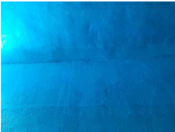
손상내용 2지 벽체 백태 손상원인 온도차로 인한 습기흡착
